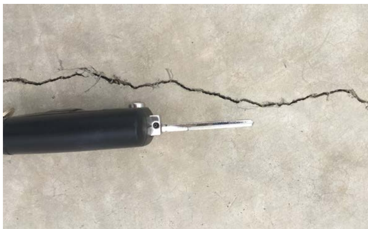
↑ Foto 3. Fisuras de retracción por secado. JOSE ANTONIO RODRÍGUEZ
