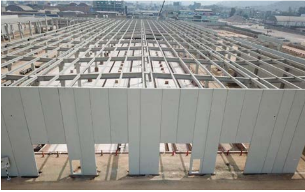
↑ Foto 2. Talleres de mantenimiento para el Metro de Lima en prefabricado de concreto.
